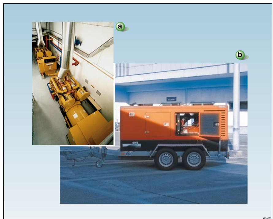
Bild 3 Notstrom-Dieselaggregate können fest installiert oder mobil sein
